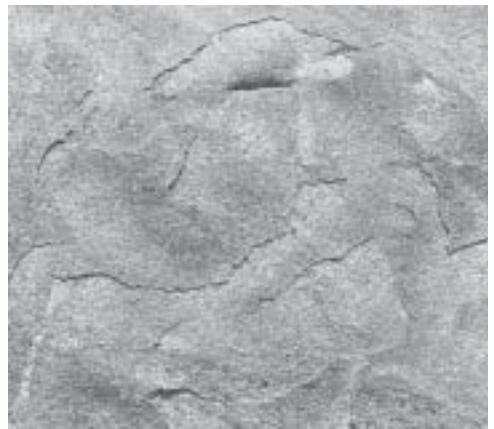
Fig. 3. Descamación por alteración en granitos (Coruña, España).
