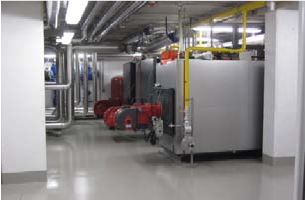
Sala de Caldeiras Rematada
