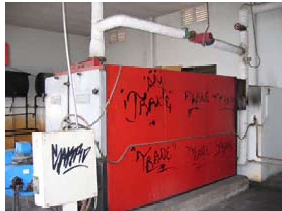
Acceso non permitido por fachada acristalada á vella sala permitía o vandalismo sobre a mesma.
