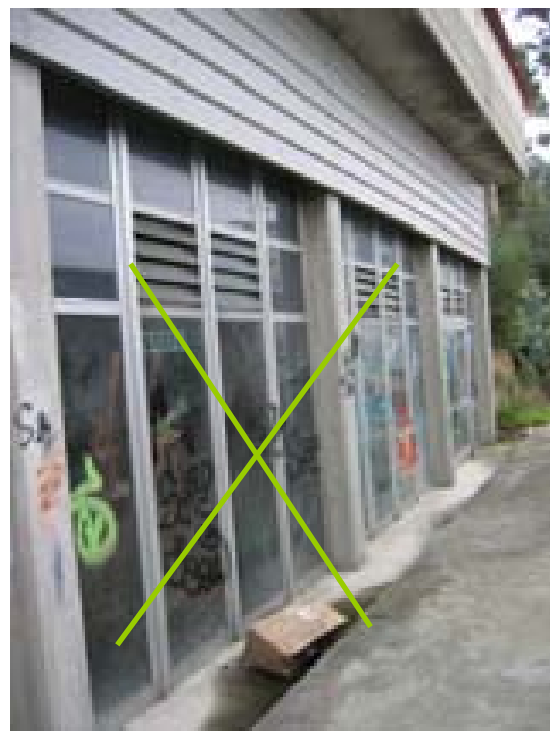
Sala de caldeiras non cumpre normativa RF en zona de acceso público
