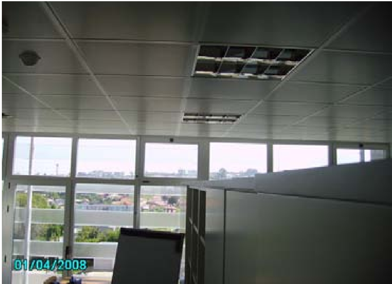
LUMINARIAS UBICADAS ENRIBA DE ARMARIOS POLA DIVISIÓN DE ESPAZOS
