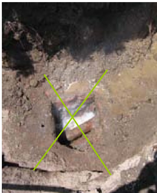
Fuga de auga nunca tubaría de calefacción soterrada
