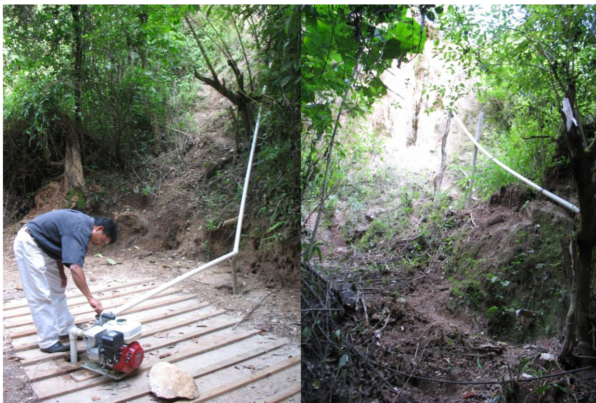
Felipe sobre o pozo poñendo a bomba en funcionamento
