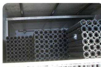
Relleno Bionet instalado
