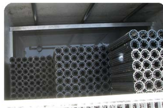
Relleno Bionet instalado
