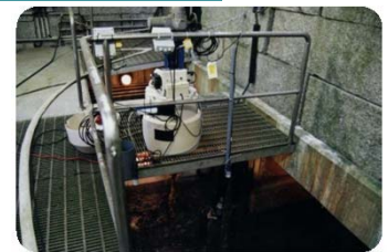
Sección de control "Cancelón"
